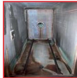
Soporte de filtro izquierdo con corrosión particular Causa: La fuerte oxidación de la cámara de esterilización produce daños por óxido atmosférico/oxidación secundaria
