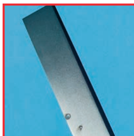
Ejemplo de corrosión de picadura
