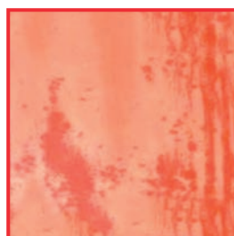
Daños en el material de la superficie de aluminio anodizado natural/metalizado en contenedores. Causa: solución de lavado con niveles de alcalinidad no permitidos
